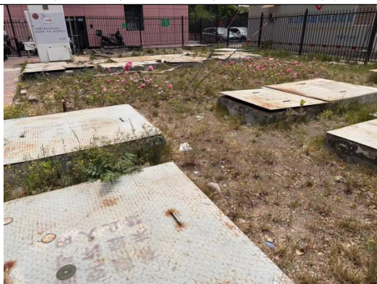
污水站地下水池
