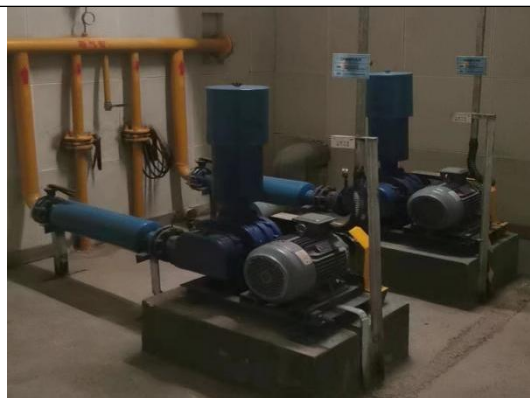
污水站内部设备
